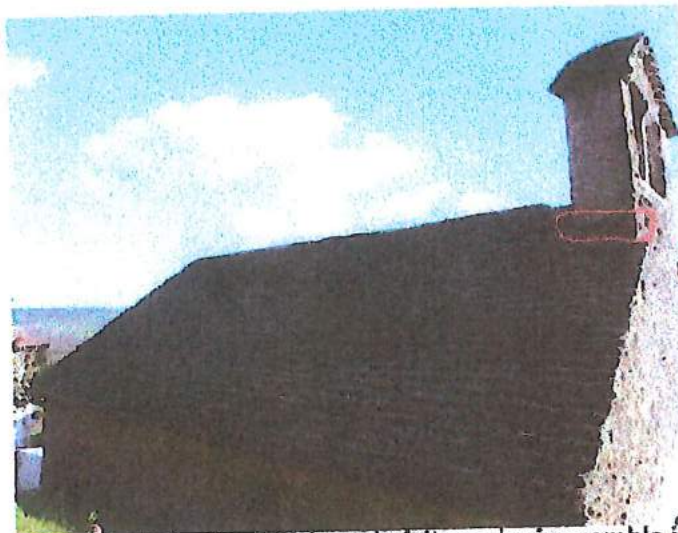
En haut à droite de la rive, une lave de faitage de rive semble indiquer une pente précédente plus forte.
