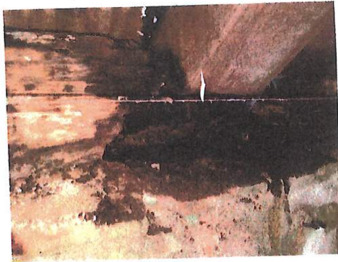
Portion de panne sablière détruite par le pourrissement au niveau de la retombée du 3ème chevron en partant de gauche (sur la photo précédente).
