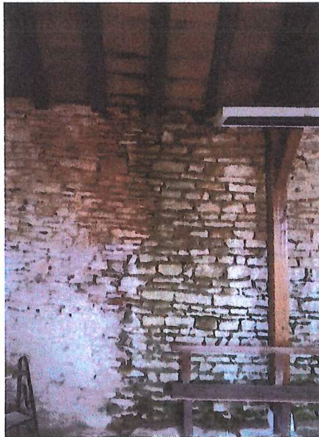
Mur nord côté ouest à l'intérieur de l'église. Traces d'infiltrations d'eau de pluie au niveau des voliges et traces d'humidités sur le mur.
